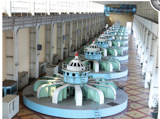
Машинна зала ДніпроГЕС-1.
